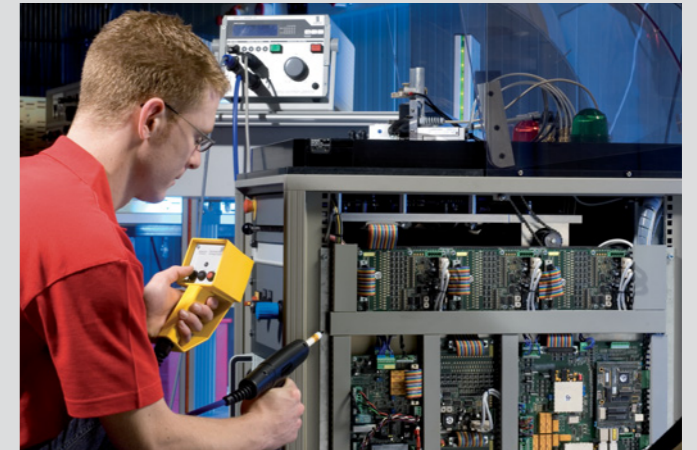
EN60204-Prüfung an einem Schaltschrank
